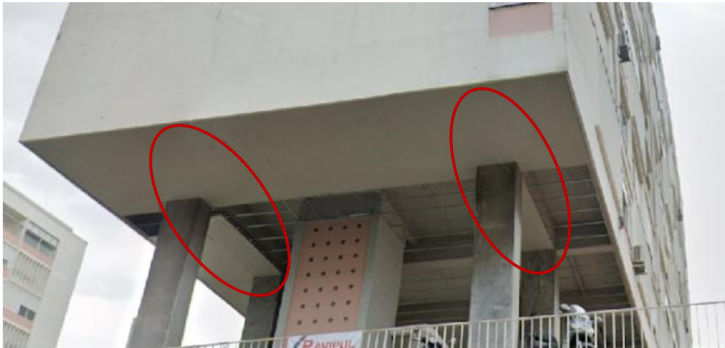
Figura A1: Imagem do teto do piso térreo do bloco de habitação da Av. Infante Santo onde se destacam as vigas V9.
